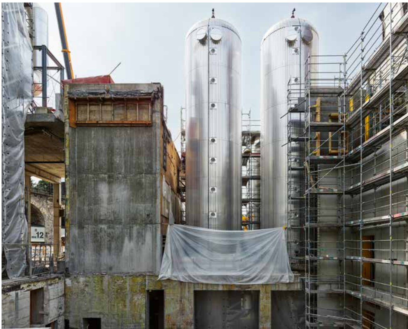
2 Die ehemalige KVA Josefstrasse in Zürich-West wird zu einer Energie- und Speicherzentrale umgebaut (Graber Pulver Architekten).
