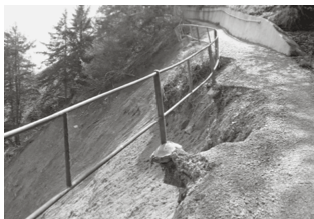
Abgerutschter Föhreneggweg am Uetliberg. (Bild: GSZ)
