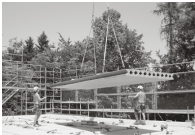
Beim Erweiterungsbau des Werkhofs Albisgüetli wurden vorgefertigte Boden-Decken-Elemente in Triasol-Technik verwendet. (Bild: GSZ)
